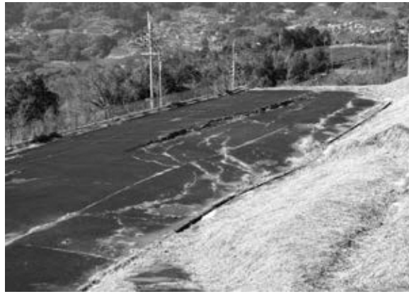
敷地の変状の状況
